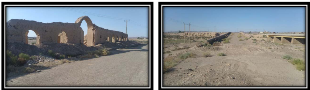
تصاویر ۷ و ۸: سردر اصلی کاروانسرا و روگذر پل عسگرآباد در همجواری جاده قدیم تهران به قم (نگارندگان، ۱۴۰۲).
